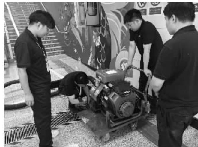
■工作人员进行汛期前设备专项检查。 通讯员 田张梦 摄
