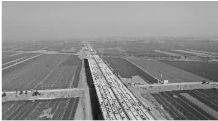
■国道G515无极绕城段木刀沟特大桥梁加紧建设。通讯员 王建勋 摄
