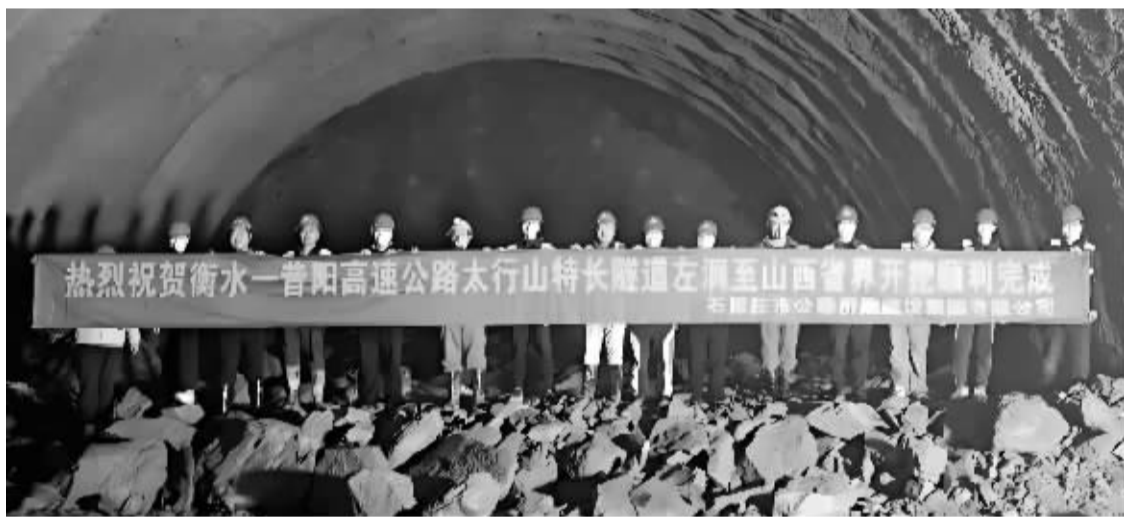
■衡昔高速太行山隧道河北段长 3.9 公里。(石家庄交投集团所属衡昔公司供图)
