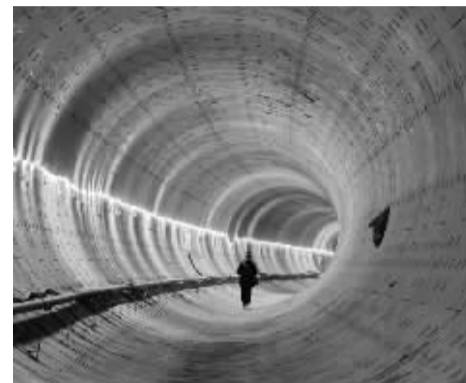
石家庄地铁6号线仓宁东路站—仓盛东路站区间已经贯通的左线隧道。
