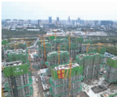
■南村城中村改造项目建设现场(资料图片)。 通讯员 张耀宇 摄
