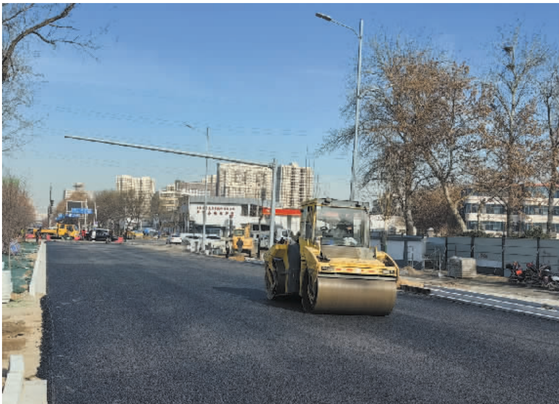
■昨天,平安大街南延工程施工现场,压路机碾轧路面。本报记者 张海强 摄
