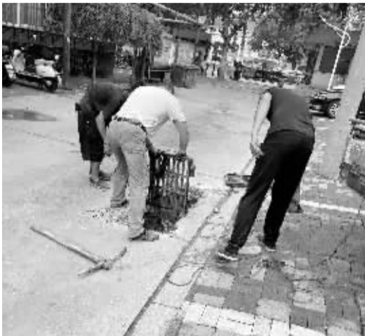
■提前清理雨水井保障排水通畅。
