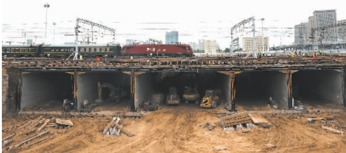
■新客站南地道下穿京广铁路框构桥顶进工程施工现场。 本报记者 张海强 摄
