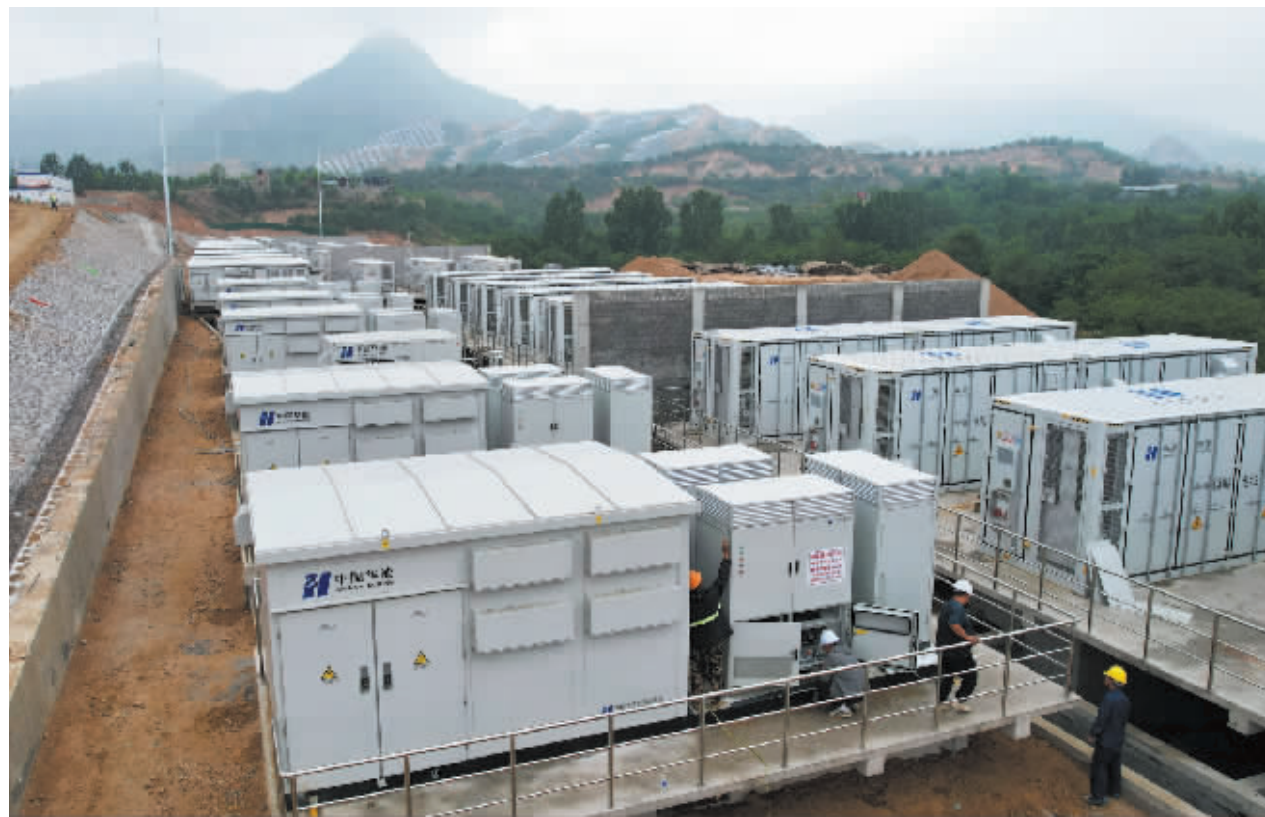
河北石家庄： 建设新型储能站 助推新能源高质量发展
