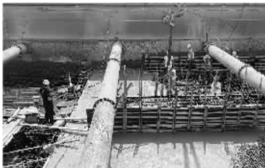
■地铁4号线一期工程石铜路车站首段顶板浇筑完成。(市轨道集团提供)
