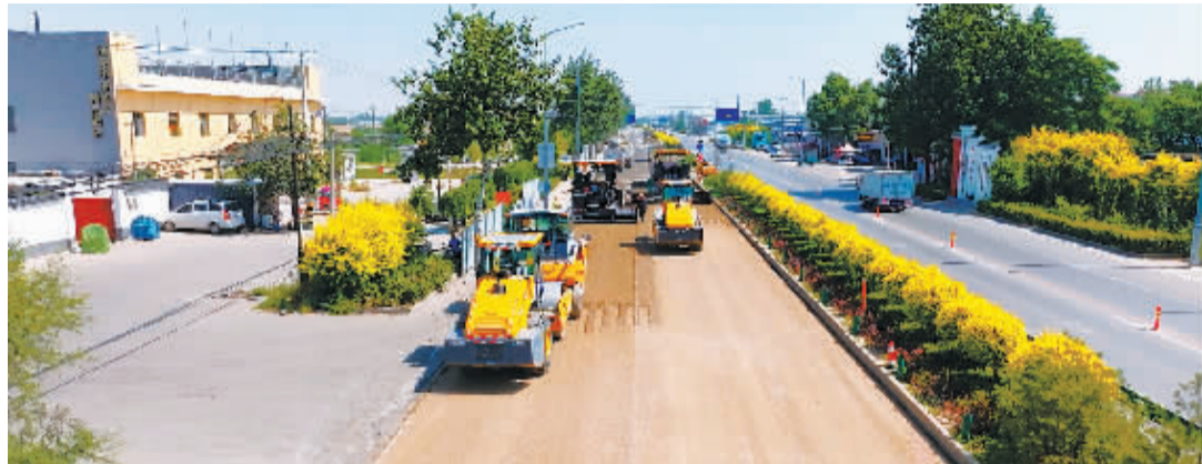
■国道107线新乐南环至正定新安镇段大修现场。(石市交通局供图)
