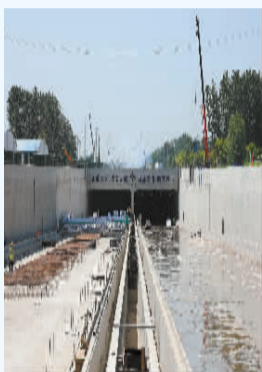
复兴大街市政化改造项目迎旭门隧道6月15日成功封顶。图为隧道北口。
