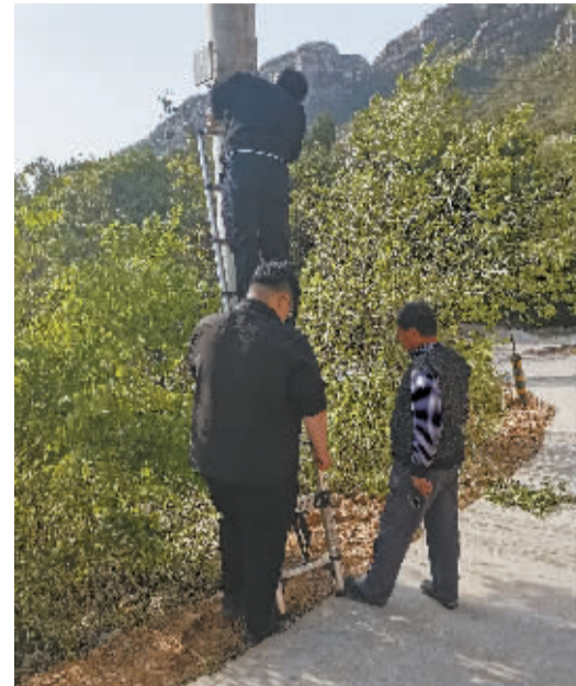
■民警侦破期间,调取位于山腰电线杆上的监控。
