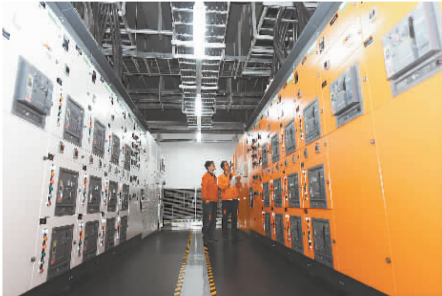
■4月26日,在正定高新区常山云数据中心,工作人员对设备运行情况进行巡检。
