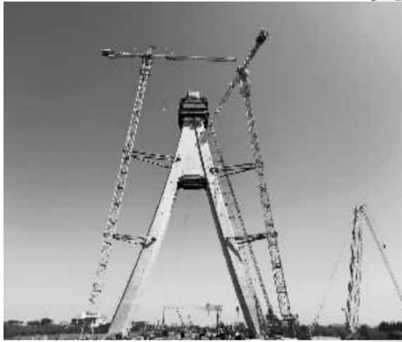
■学府路东延跨太平河桥梁工程,主桥合龙、主塔封顶。 本报记者 张海强 摄
