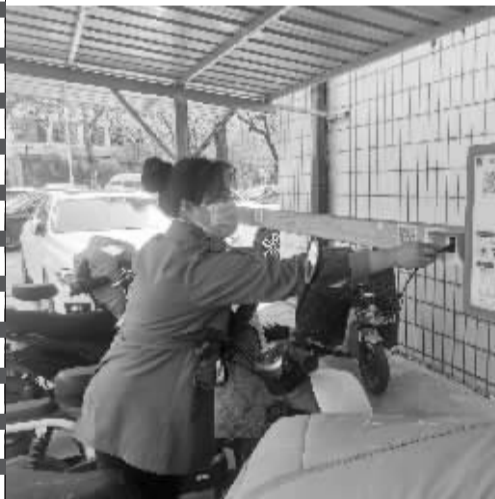
■小区里设置的电动自行车充电设施。
