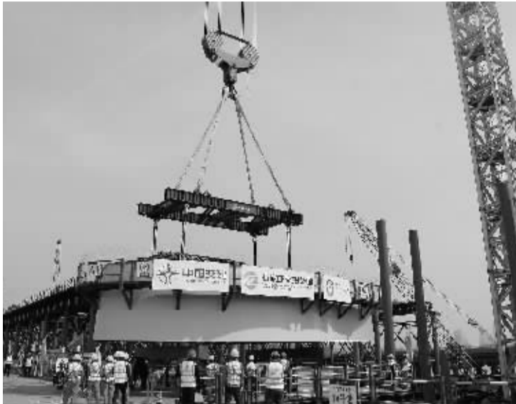
■首节钢塔的吊装完成标志着大桥主塔施工进入决战阶段。
