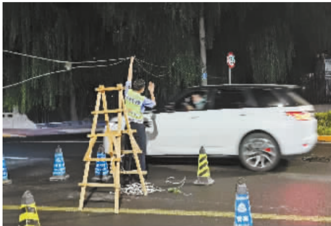
■交警托举起脱落的光缆。
