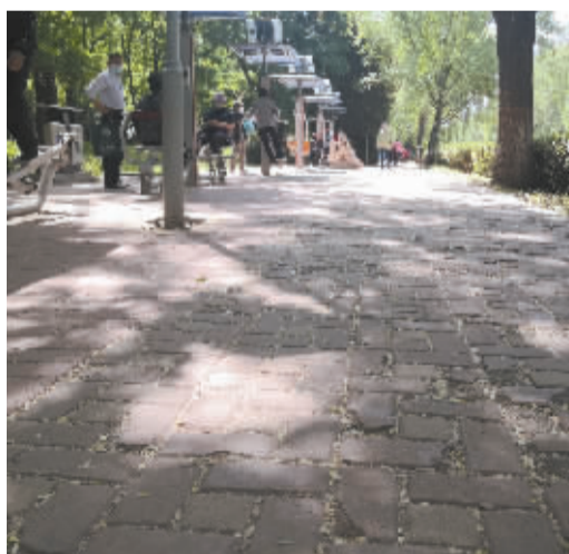
■公园西侧的一些地砖存在破损情况。
