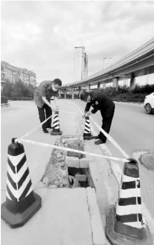
■目前缺失井盖的雨水井周围采取了警示措施。
