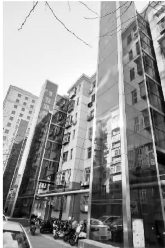
■9号楼三个单元安装的玻璃墙外挂景观电梯。
