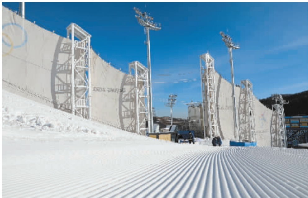
■随着北京冬奥会的临近,日前,防风墙在北京冬奥会张家口赛区云顶滑雪公园亮相。防风墙的建立可以有效地减小大风对运动员的干扰,保证赛事的正常运行。 新华社发
