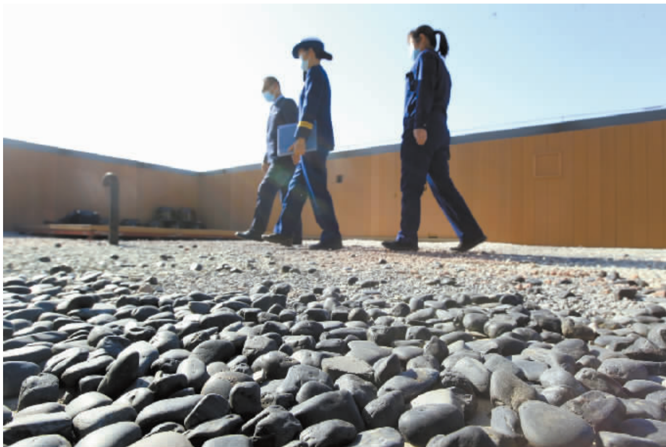
■隐患! 某酒店 30 楼顶层有很多鹅卵石,消防部门要求清理。
