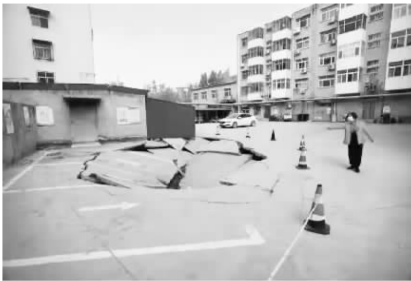
■路面塌陷,形成一个长约9米、宽约4米、深逾1米的坑洞。记者 东方 摄
