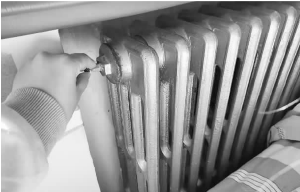
■暖气漏水点不同，处理方法也大不一样。
