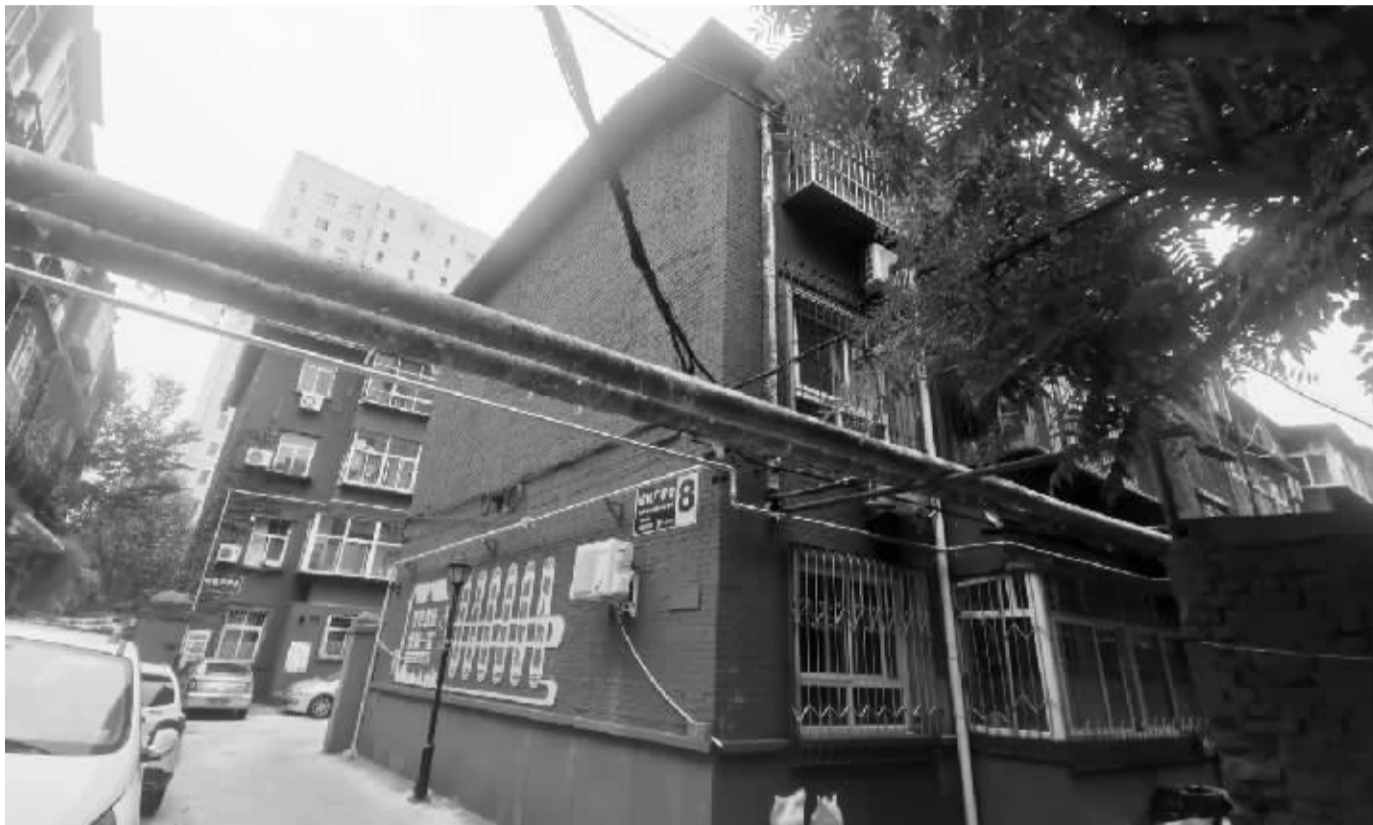
■ 8 号楼前供暖管网阀门附近管道裸露。
