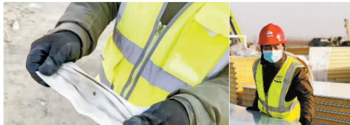
■赵栋梁的口罩里全是沙土。
