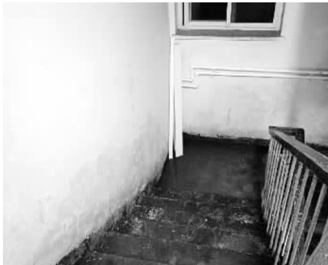
■水顺着楼梯往下流。
