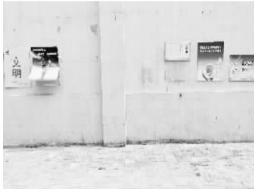
■育才街171号院北侧墙上受损的公益广告。
