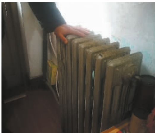
■3号楼3单元东门业主家南卧室暖气冰凉。
