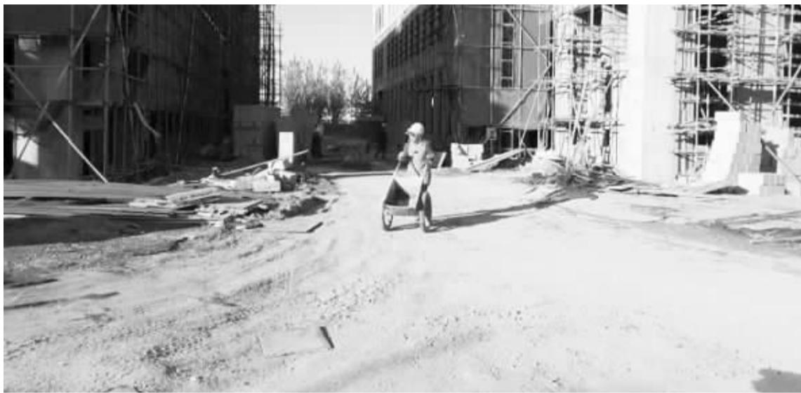
■施工现场裸露地面,未落实 100%硬化。
