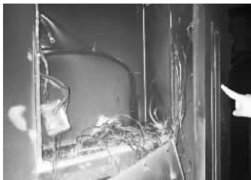
■12楼电表箱里的电表烧掉了。
