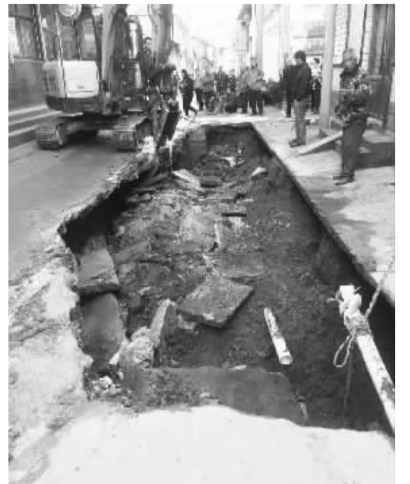
■北贾村路面塌陷现场。
